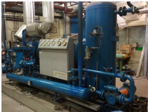
Übersicht Kälteanlage 2 – TK 3
