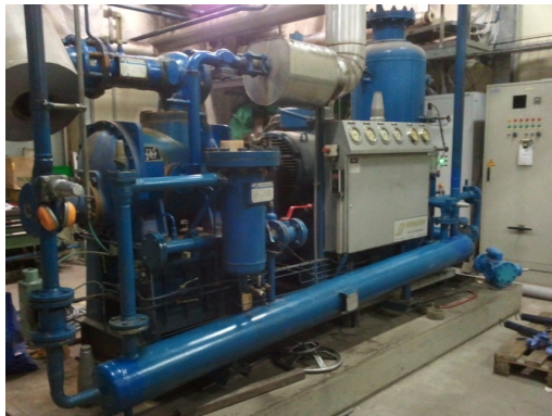
Übersicht Kälteanlage 1 – TK 3
