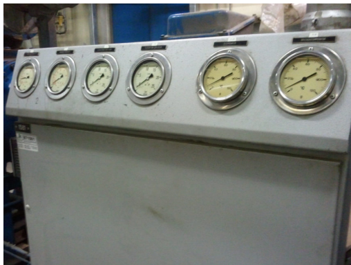
Anzeigetafeln Kälteanlage TK 3
